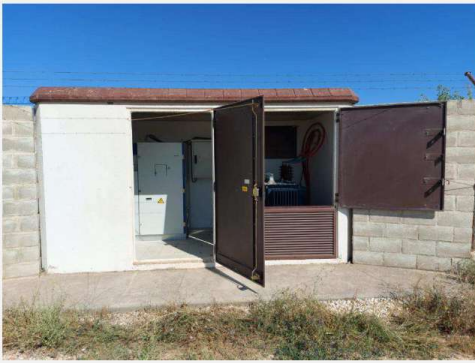
Limpieza y mantenimiento Centros de transformación
